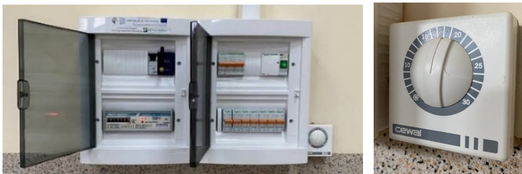
Рис. 4. Фото системи керування інфрачервоними панелями: щиток моніторингу, електрощиток, кімнатний термостат
