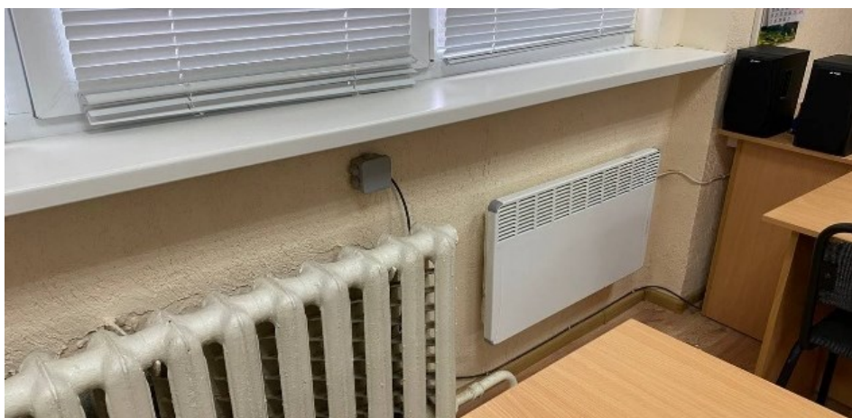
Рис. 8. Опалювальні прилади аудиторії №9206
