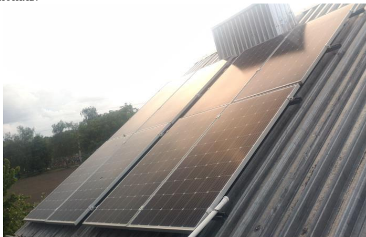
Рис. 1. Фотоелектричні панелі на даху будинку
