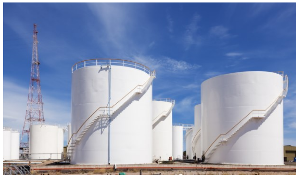
Рис. 1. Зберігання нафтопродуктів у металевих резервуарах
