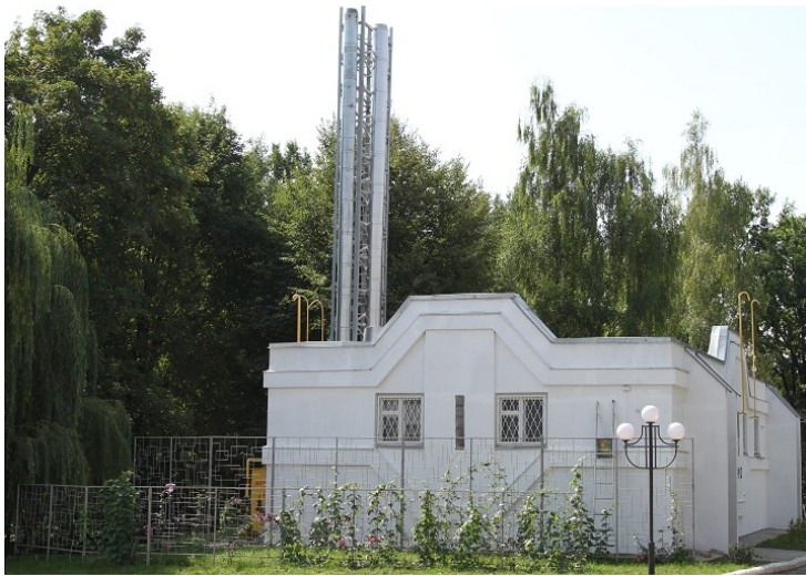
Рис. 1. Зовнішній вигляд автономної котельні ХНУ
